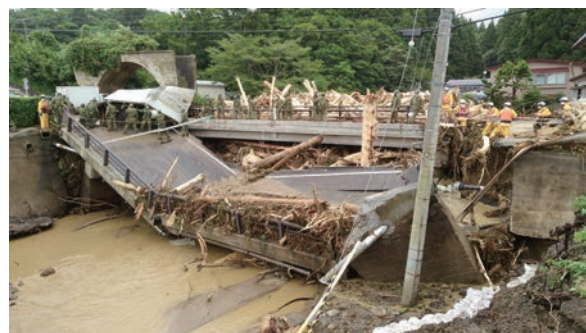
国道279号小赤川橋の落橋
