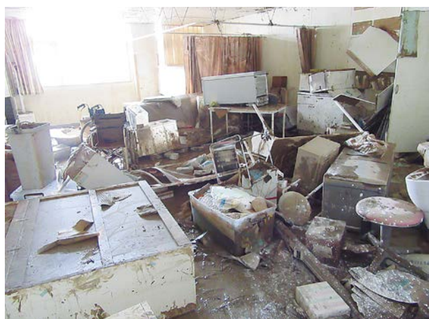
浸水被害状況（教室内部）
