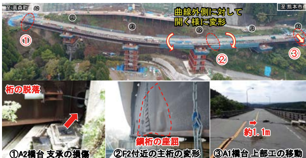
大切畑大橋の主な損傷状況
