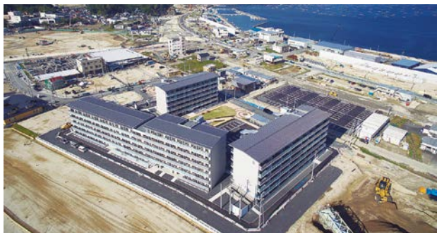
基盤整備工事で並行して災害公営住宅建築工事を推進する様子
