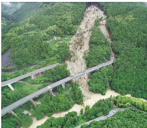
高知自動車道（立川橋）の被災状況
