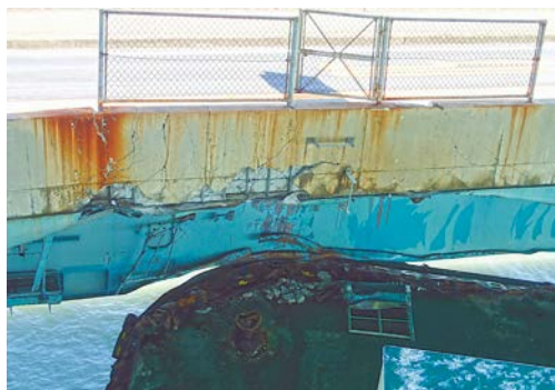
桁の損傷状況
