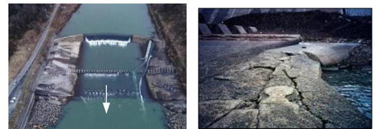
図2 老朽化が進行する第二床固
