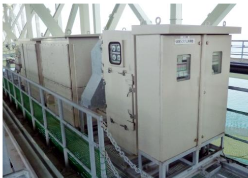
送気用機械設備
