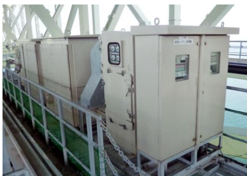
送気用機械設備
