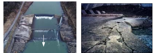
図2 老朽化が進行する第二床固
