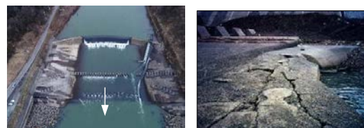
図2 老朽化が進行する第二床固
