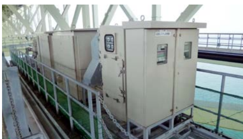
送気用機械設備
