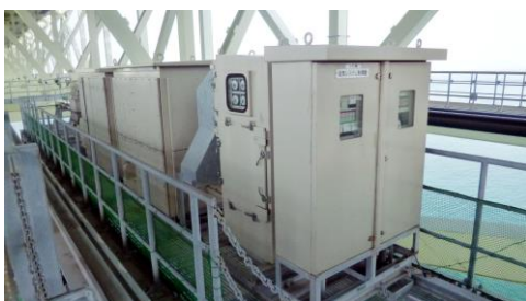
送気用機械設備
