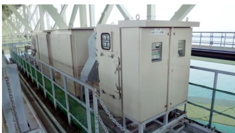
送気用機械設備
