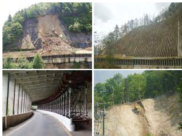
法面工及びスノーシェッドの被災直後・完成と工事の様子
