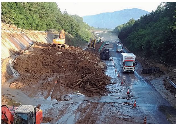
緊急車両通行状況（山陽自動車道）
