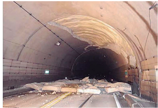
俵山トンネルの被災状況
