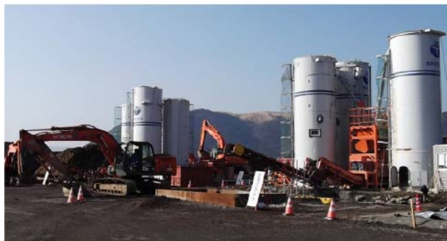
全国初の砂防ソイルセメント集中プラント
