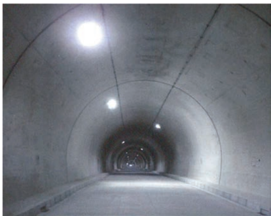
トンネル照明に長寿命なLEDを採用 従来の光源に比べ消費電力を60%削減
