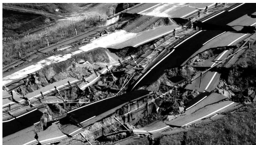
図-1 盛土部の大規模被災状況
