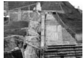
コンクリート運搬設備 (ベルトコンベヤ) 全景
