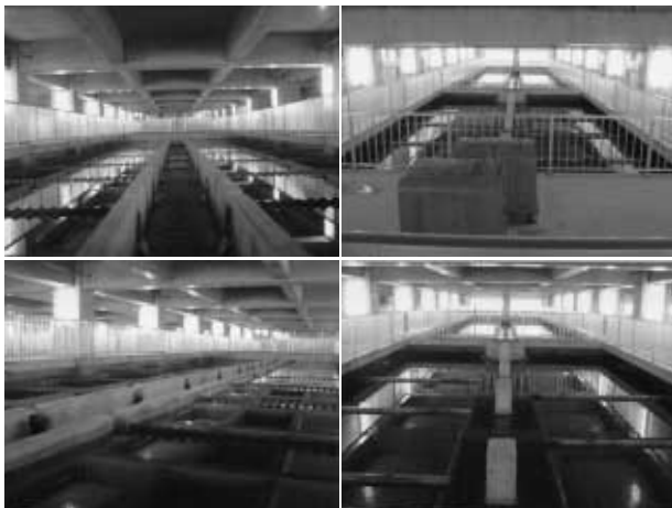
尼崎市東部第1浄化センター水処理（内部）施設
