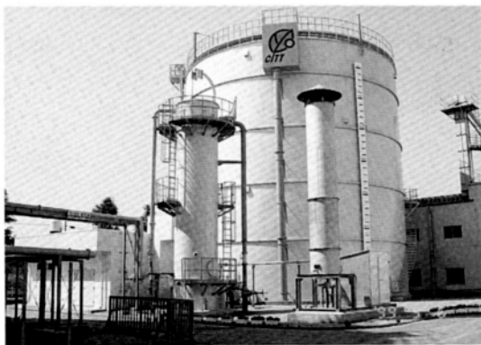
ガスタンク全景
