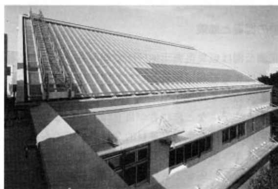
太陽光集熱パネル太陽光発電パネル可動ひさし
