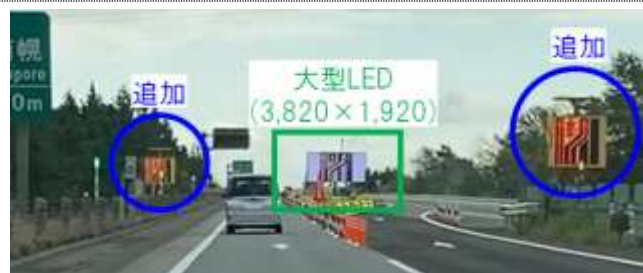
〔写真6〕⑩分岐ルート手前のLED標識設置状況
