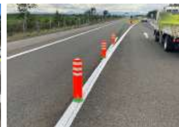
〔写真5〕 ⑦ポストコーン接触防止対策(ポストウイングカバー設置 (供用6日目))
